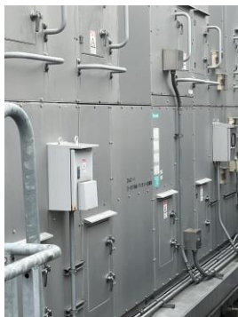
デシカント空調設備
